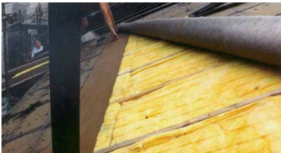
STAMISOL DW nach 7-jähriger Freibewitterung ohne Dacheindeckung aufgrund eines Baustopps. Geöffnetes Dach bei einer Probeentnahme in Vernate, Schweiz.
